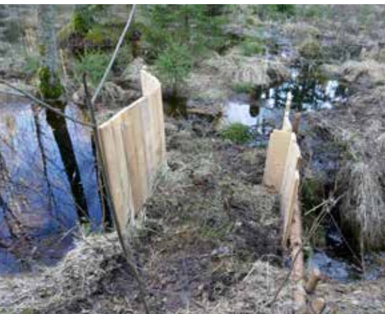
Effektiv palissadplugg. 78 cm nivåskillnad före och efter pluggen. Foto: Stefan Anderson.
