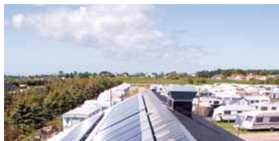
Vakuumsör fångar effektivt solvärme till varmvatten, Södra Näs Camping. Bild: Euronorm AB.
